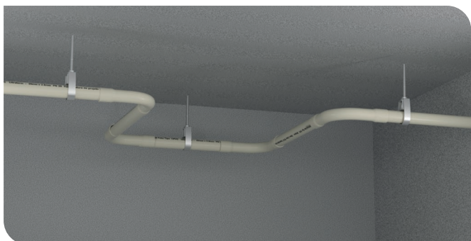
Forma prática de permitir a dilatação térmica. Lira em forma de "U".
